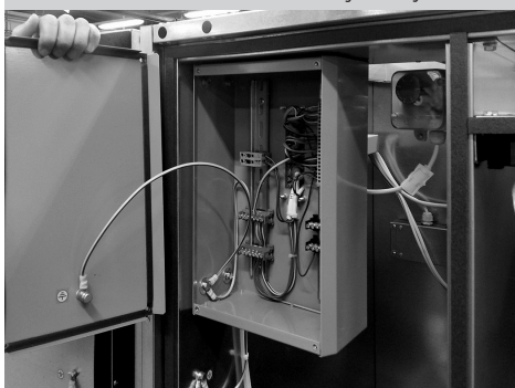
Obrázek 16 – switchbox v rámci VZT jednotky
