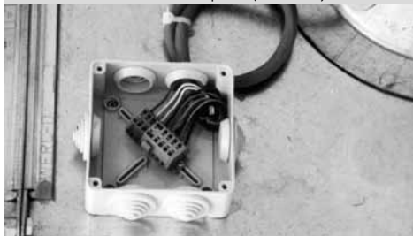
Obrázek 7 – svorkovnice na plášti (3f. motor)
