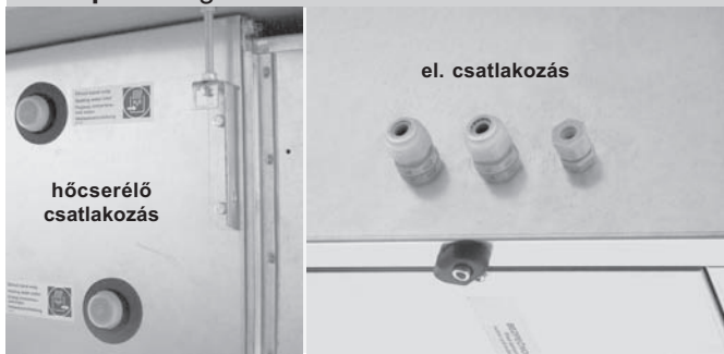
8. kép – energia csatlakozás
