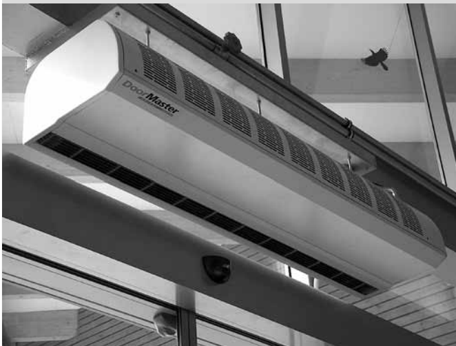
Obrázok 3 – inštalácia nad vchodové dvere
